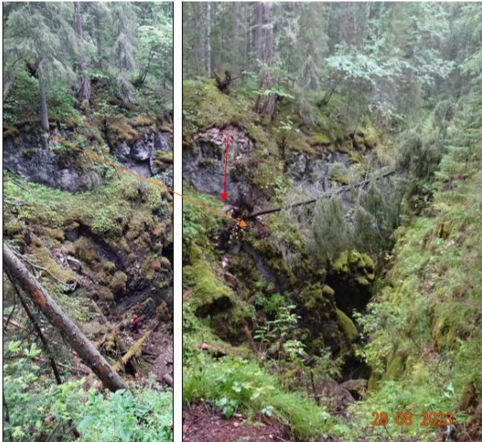
Фото 66-05-00191. Т.н. 340. Частичное обрушение западного склона провала. Нижнесергинский участок, Свердловская область
