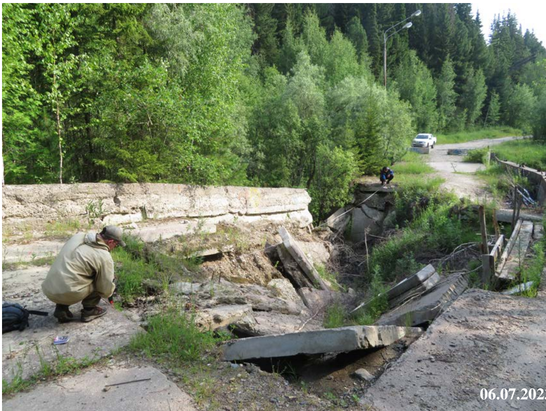
Фото 86-1210-0516-1. г. Ханты-Мансийск, ул. Сутормина, мост разрушенный оврагом. ХМАО-Югра
