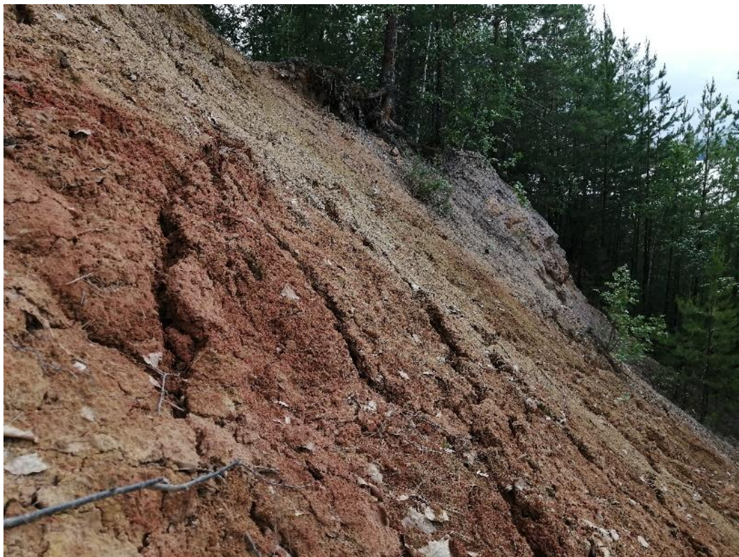
Фото 66-11-00289. Южная стенка срыва Волковского оползня (т.н. 128). Длина трещин 3,1 м. Каменский участок, Свердловская область.
