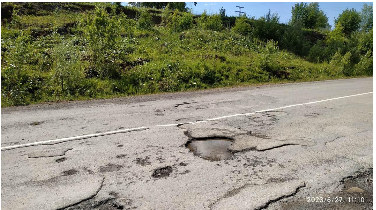
Фото 74-11-00048. Разрушение оползневым процессом асфальтового покрытия автодороги на горнолыжный комплекс Аджигардак. Участок Ашинский, г. Аша, Челябинская область
