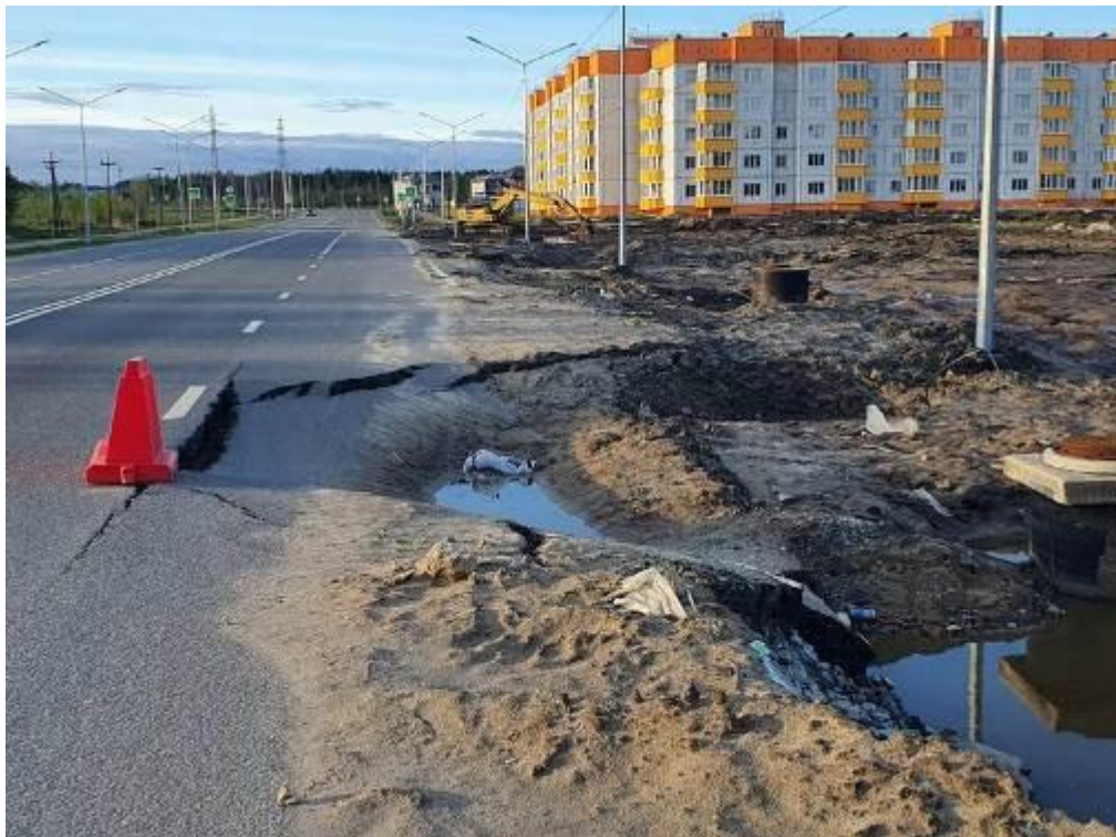
Фото. 86-2023-01-001-3. Пос. Белый Яр Сургутского района. Состояние автодороги к микрорайону «Гидронамыв». 19.05.23г. (снимок: фото с сайта «Ura.ru»). ХМАО-Югра
